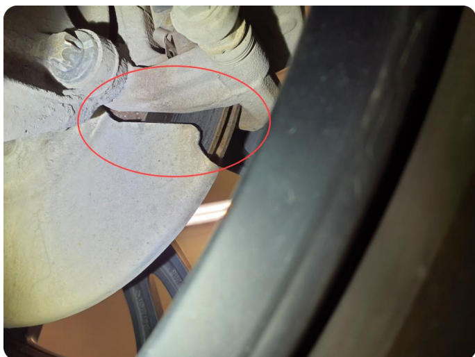
5.1 Mer enn 25% rust Mer enn 50% innerside høyre
